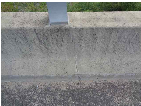
콘크리트 균열 (대구방향 S3경간)
