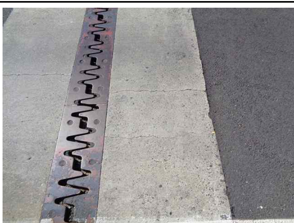
후타재 균열(상주방향 Exp.1)
